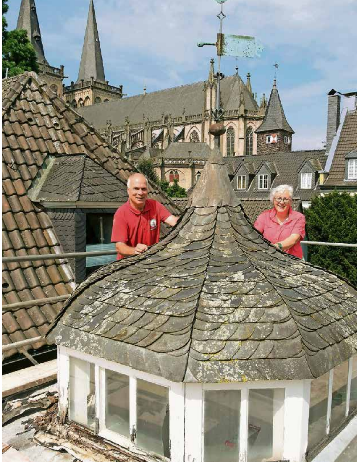
Johannes Schubert und Ute Koppers-Messing stehen auf dem Dach des mehr als 200 Jahre alten Pavillons. Am Holz der Fensterrahmen sind starke Beschädigungen. FOTOS: OSTERMANN
