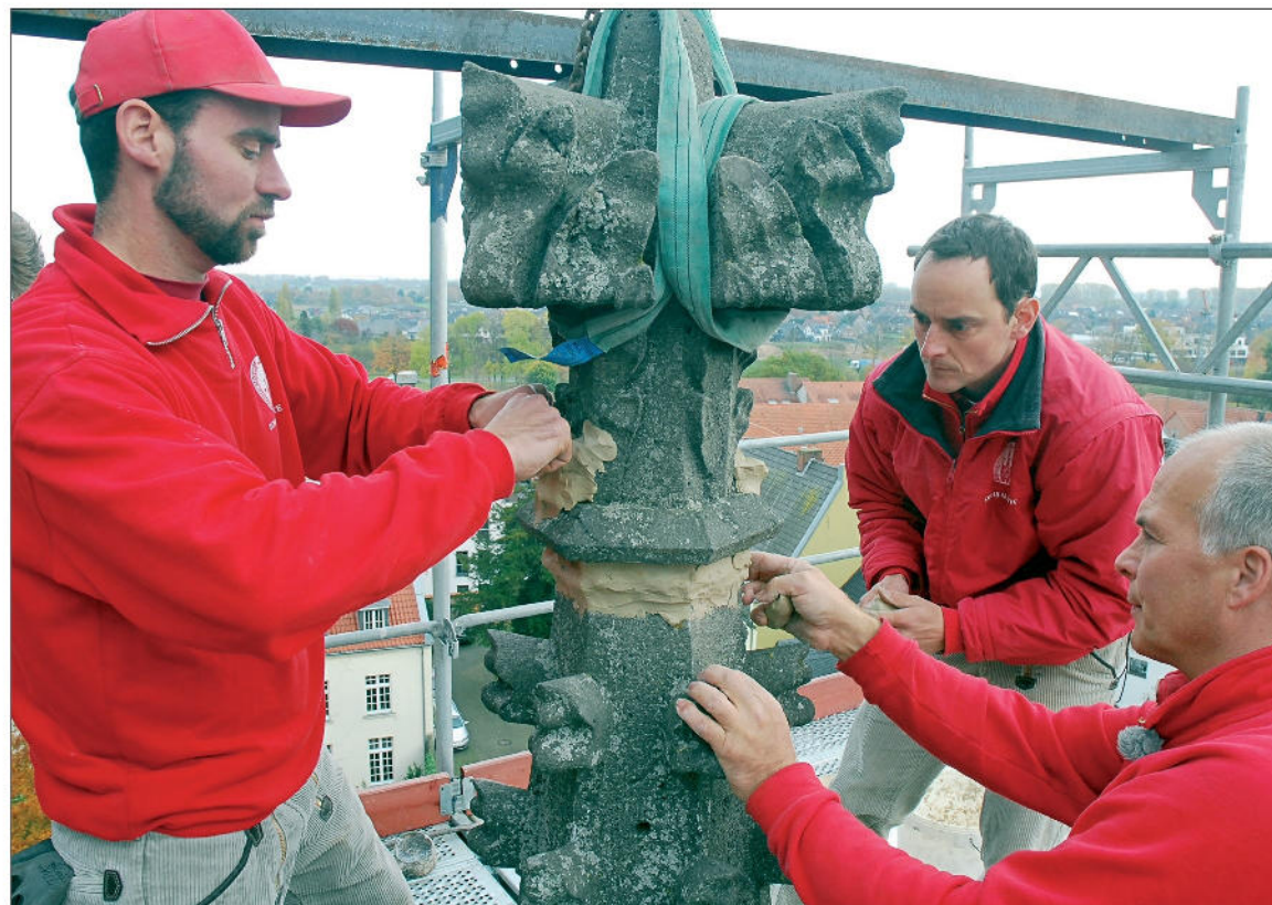
Matthias Dungs, Thorsten Knapp und Johannes Schubert von der Xantener Dombauhütte kontrollieren, dass die Fugen an Kreuzblume korrekt mit Ton abgedichtet werden.
